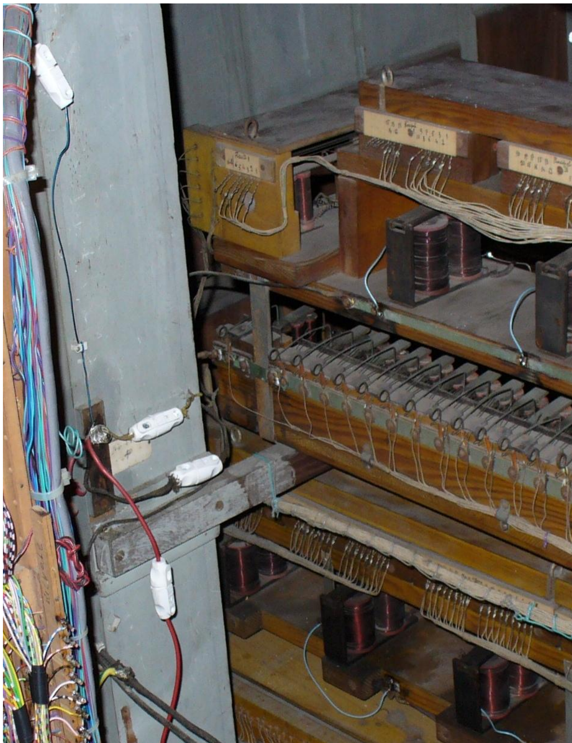
Particolare dei "relé multipli a pettine" di basseria, dopo l'intervento e dei fusibili di protezione per quattro elementi diversi
