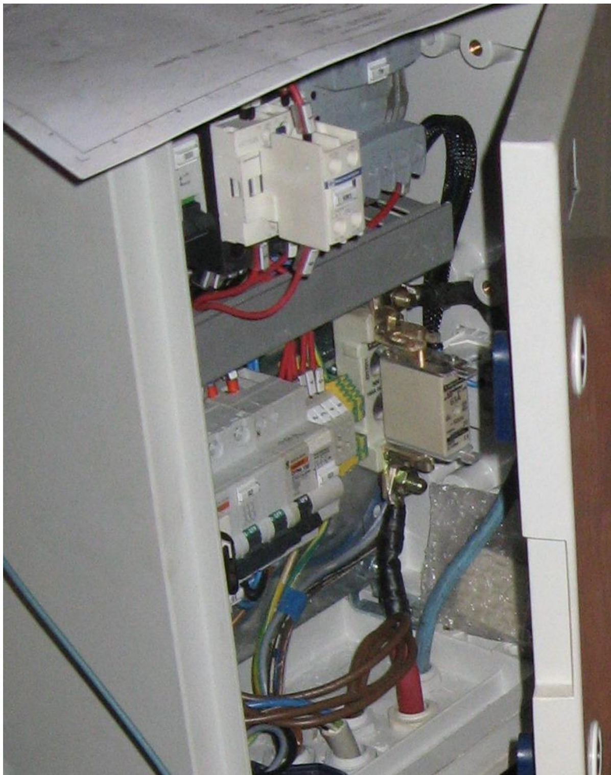
Particolare del Fusibile Generale, di protezione sui cavi principali.
