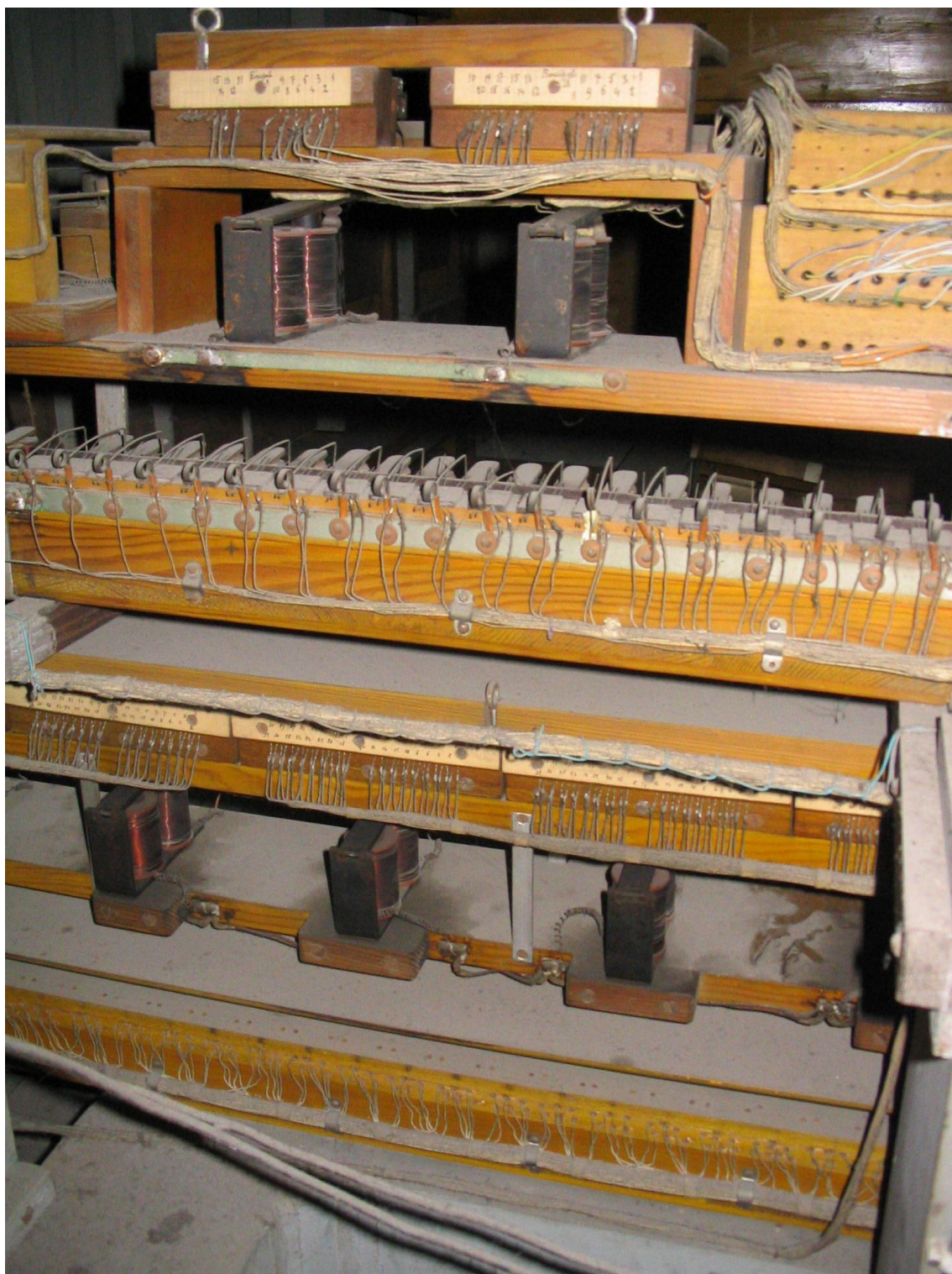
Particolare dei "relé multipli a pettine" di basseria, prima dell'intervento
