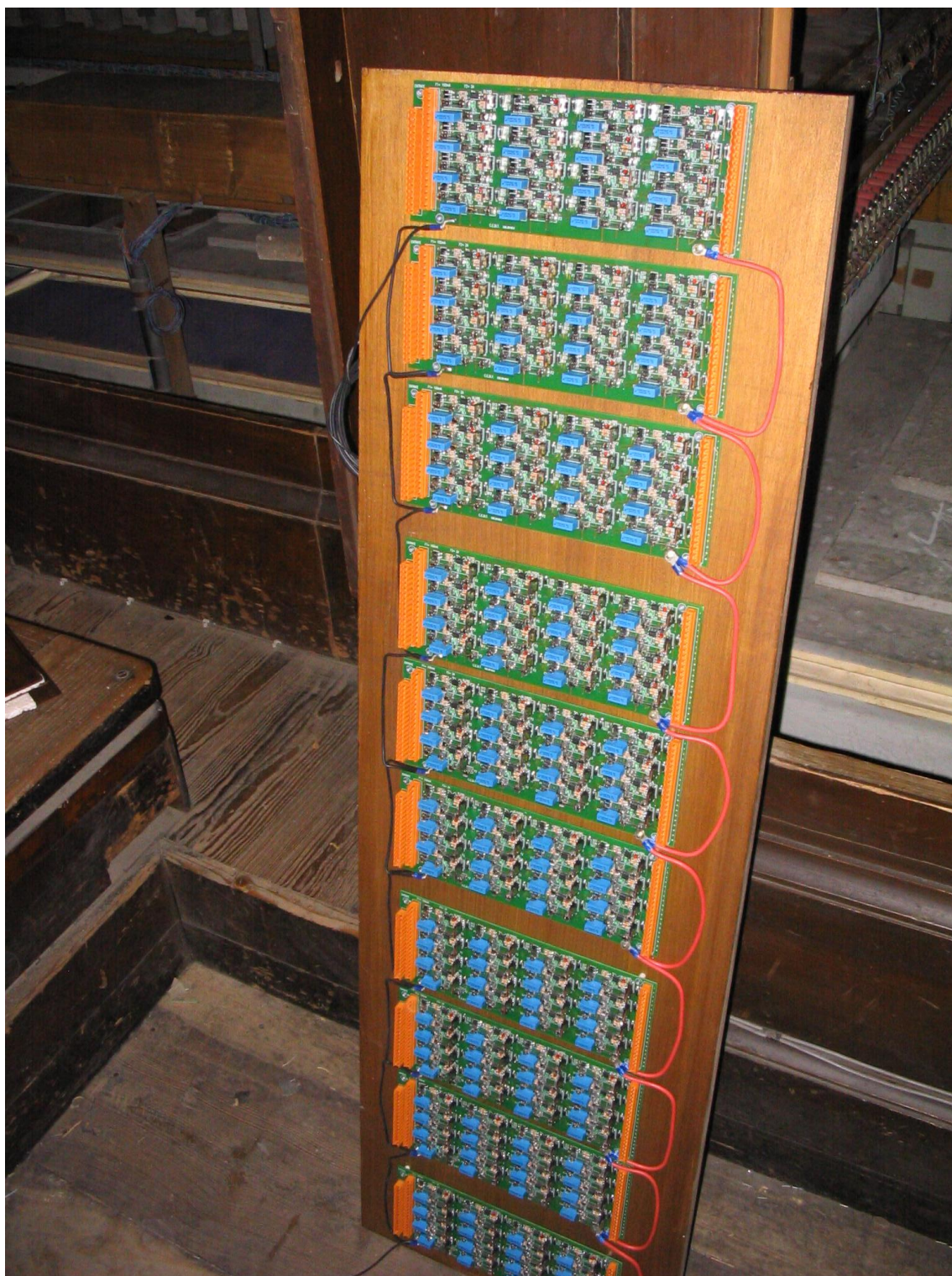
Tutte le schede prima del montaggio e cablaggio definitivo
